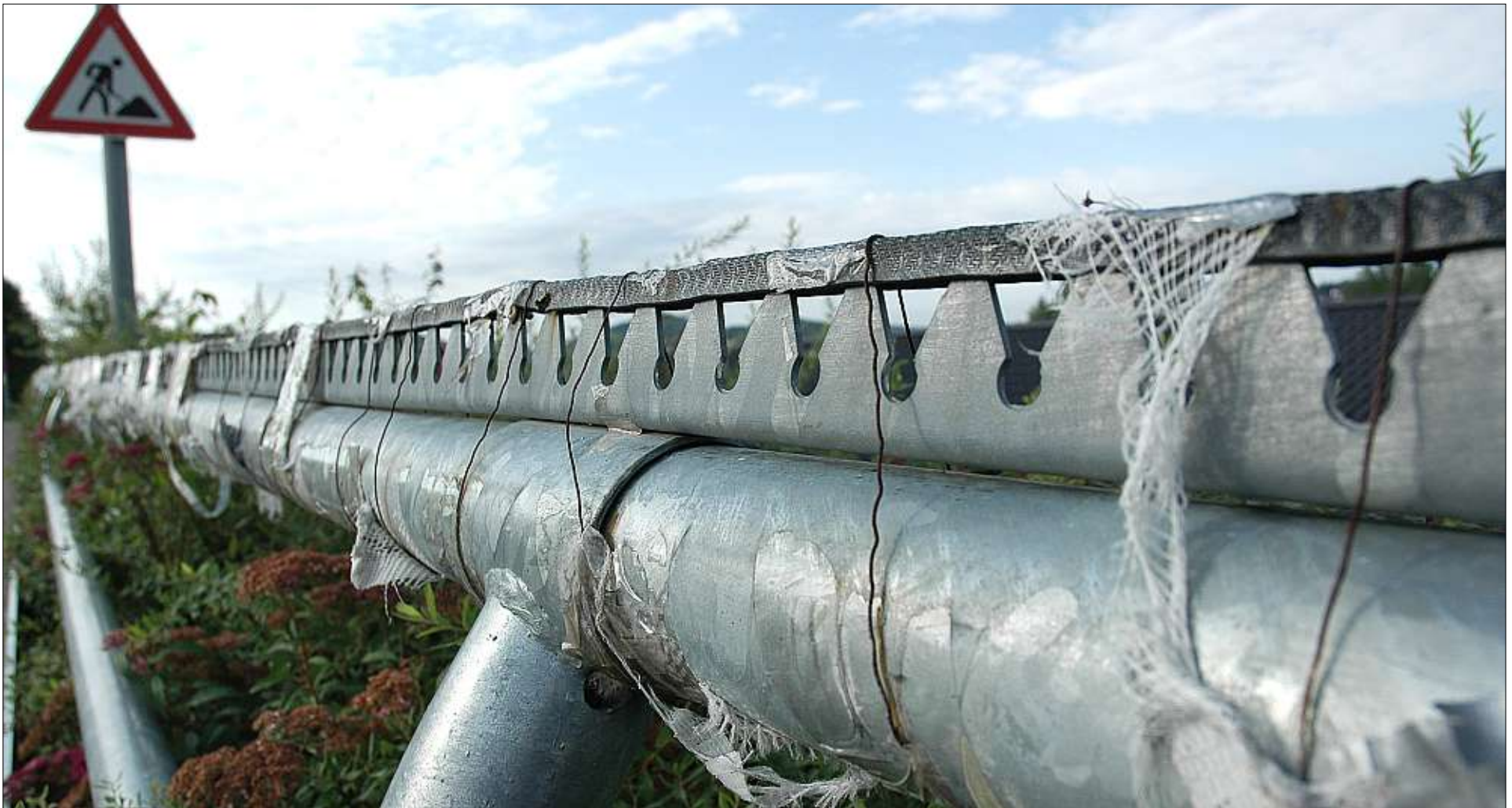
Mit einer Gummileiste und Isolierbändern wurde versucht, die Zacken auf dem Handlauf zu entschärfen: Sie sollten ursprünglich dazu dienen, zu verhindern, dass sich Schüler darauf setzen und dadurch riskieren, rückwärts die Böschung hinunter zu fallen.
